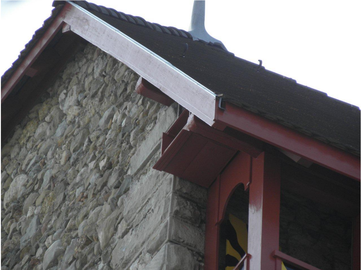
Die Nisthilfe für den Turmfalken an der Iburg wurde den bestehenden Elementen angepasst
